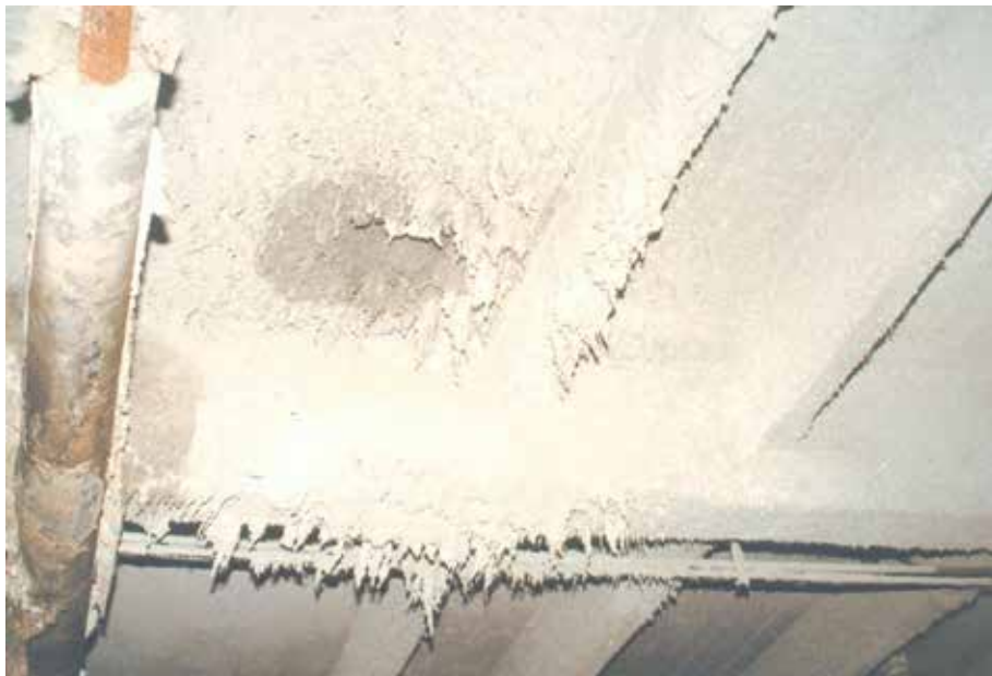
Na strop prilepljena azbestna zmes v dekantatorju Salonita v času intenzivne proizvodnje
